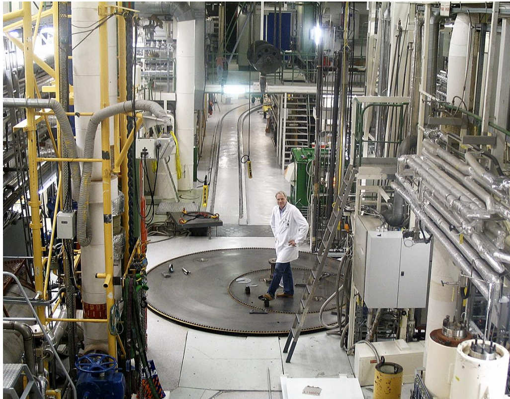
Reaktorhallen i Halden
